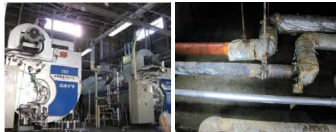
ボイラーの燃焼不具合
