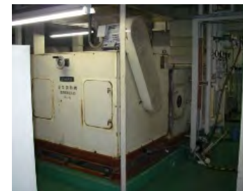
対策が必要な施設の例（重粒子線がん治療施設 空調施設）
