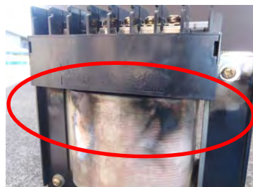
落雷による電源設備の一部破損に伴い漏電等の恐れ
