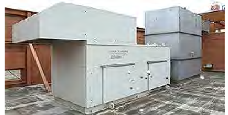
(非常用自家発電装置)
