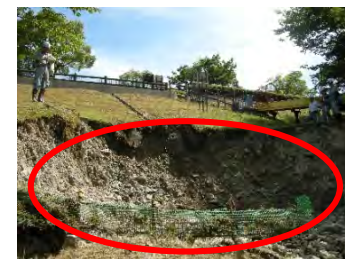
平成30年7月豪雨による法面崩壊
