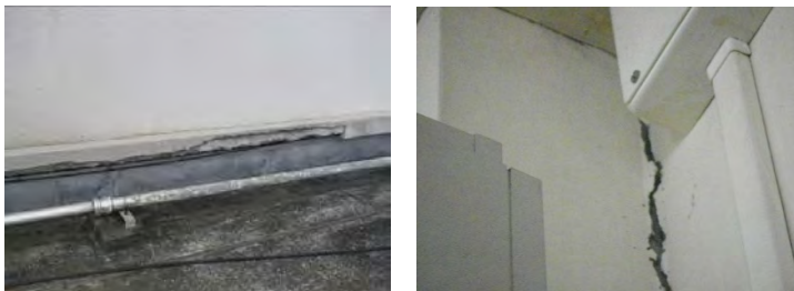
耐震性の不足した建物の劣化状況
