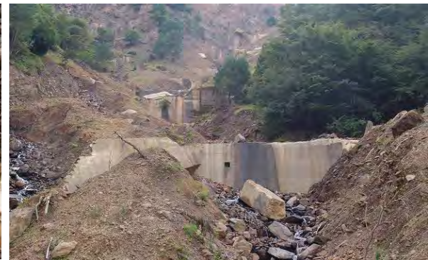
機能が低下した治山施設
