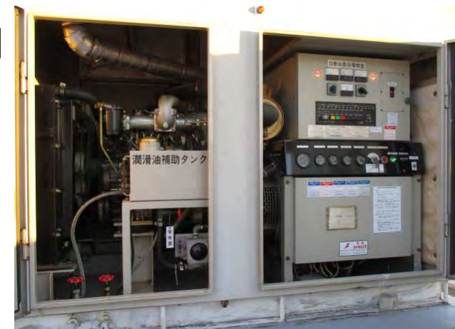
<自家発電設備>
