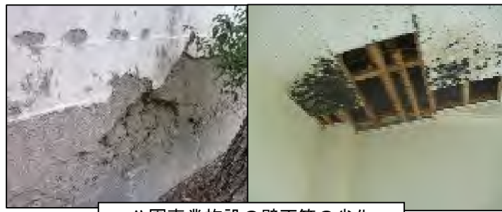
公園事業施設の壁面等の劣化
