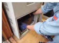
停電のためバッテリー切れした蓄電池
