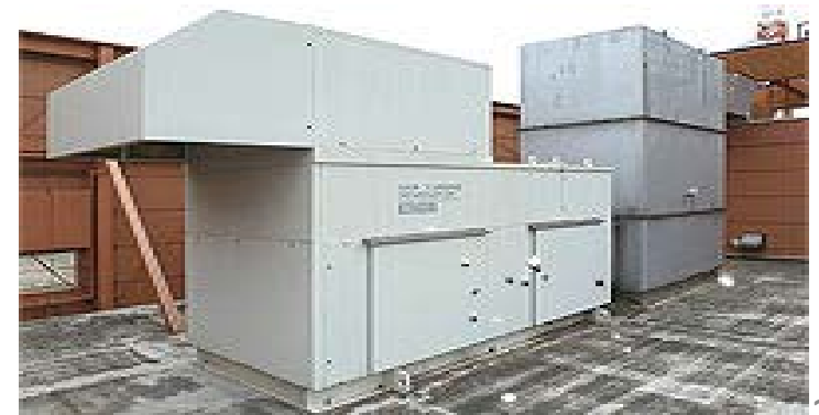
(非常用自家発電装置)
