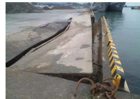
地震による岸壁の被災
