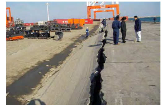
非耐震強化岸壁背後の陥没
