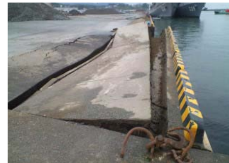
地震による岸壁の被災
