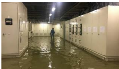
<地下電源設備の浸水被害>
