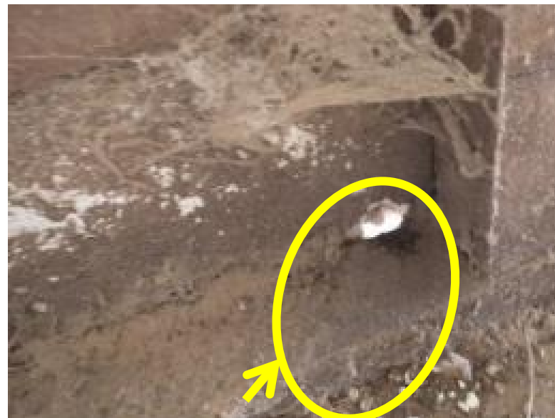
(ホコリがなく、動物の通過が 考えられる隙間)
