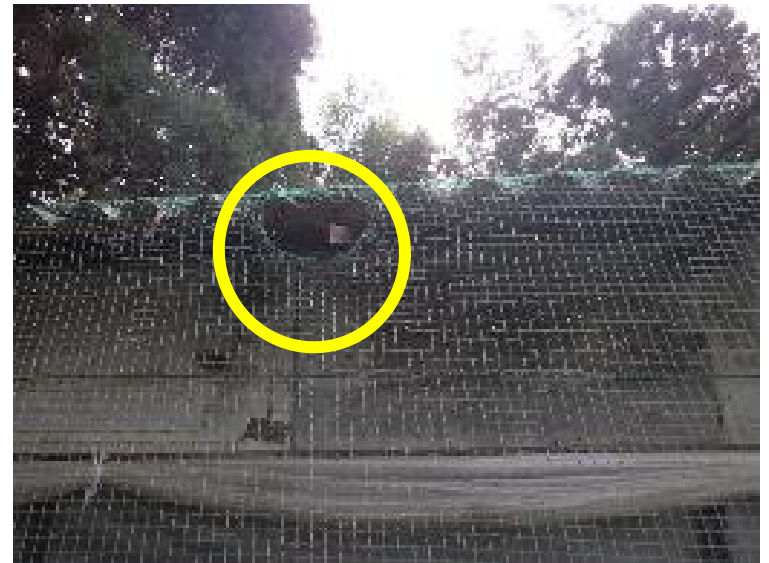
家きん舎側面の 防鳥ネットの破損
