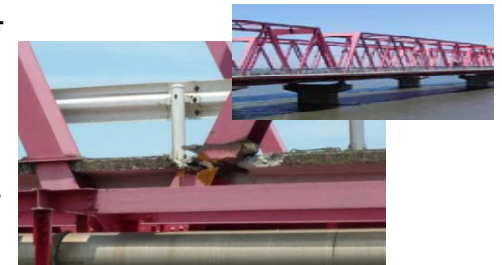
トラス橋斜材のコンクリート埋込部の腐食破断
