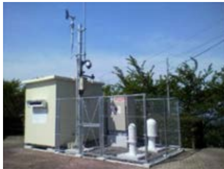
モニタリングポスト【19台】 (非常用発電機装備)
