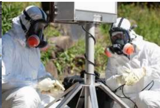
可搬型モニタリングポストの設置
