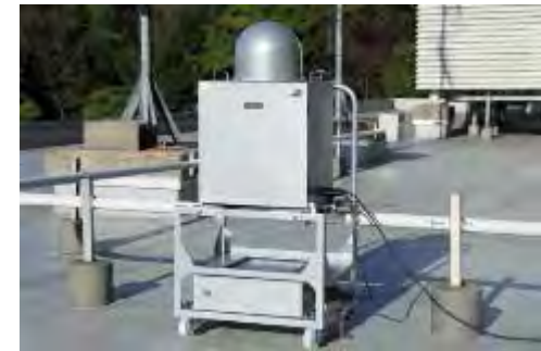
可搬型モニタリングポスト 【18台】 (バッテリー付)
