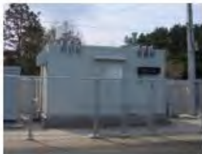
モニタリングポスト (非常用発電機装備)
