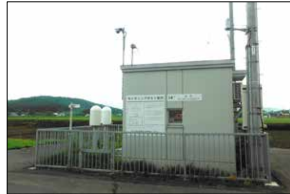
広域モニタリングポスト【12局】 (非常用発電機装備)
