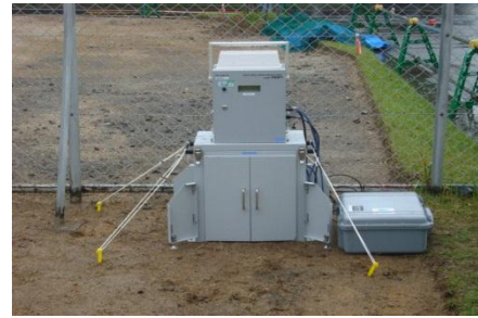
可搬型モニタリングポスト (衛星電話等による通信機能付)
