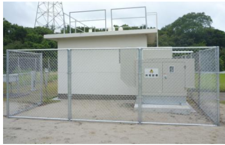
モニタリングステーション と非常用発電機
