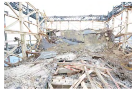
建屋上部のガレキの状況
