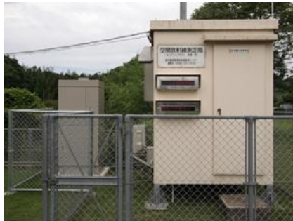
モニタリングポスト (非常用発電機装備)
