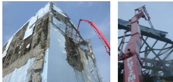
外部注水から循環冷却へ キリンによる注水(4号機の例)
